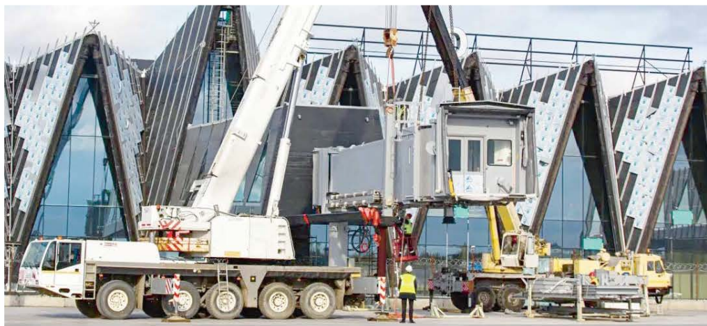
В Новом Уренгее полным ходом идет строительство воздушной гавани | ФОТО: VK.COM/ARTYUKI IGV_DA
